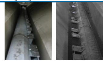
Abzugsrohr bei der Inbetriebsetzung (links) und ein halbes Jahr später nach erfolgter Spülung (rechts)
