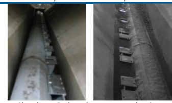
Tubes d'évacuation lors de la mise en marche (gauche) et après ½ année de service après vidange (droite)
