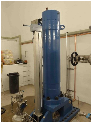
Messmodul Grundablass (Stopfbüchse)
