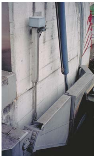
Modules de mesure vanne à segment
