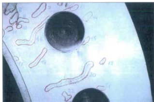
Risse in Hochdruckleitungsflansch
