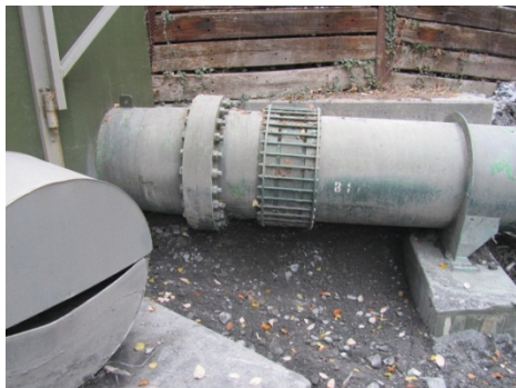
Dilatation Druckleitung nach Hochwasser
