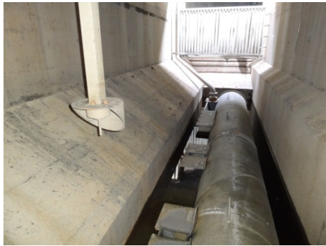
Sandabzugssystem und Sedimentmessung, Entsander GÜSAT I
