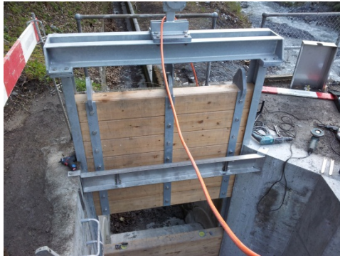
Neuer Einlaufschütze in den Kanal aus Holz
