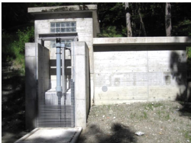
Entlastungsbauwerk mit Schütze und Messmodul; Miliüt, KW Dala
