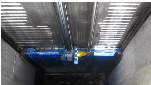
Entlastungsschütze mit Messmodul in Betrieb; Miliüt, KW Dala
